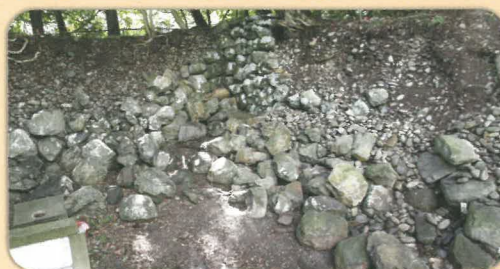
石垣の崩落状況
