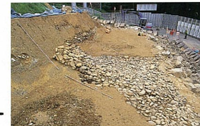
石垣の排水施設（第二世代）
