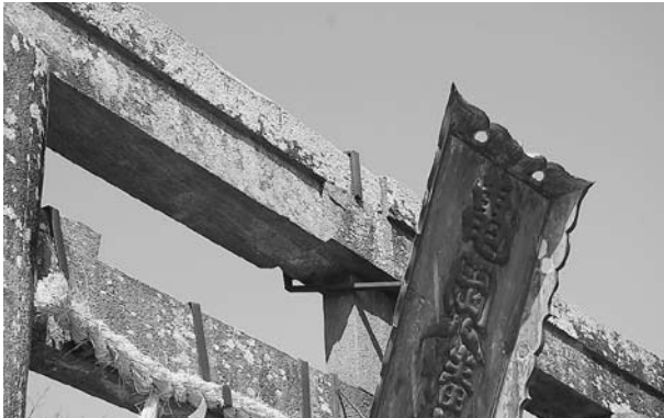
●亀岡八幡宮石鳥居の被災状況
