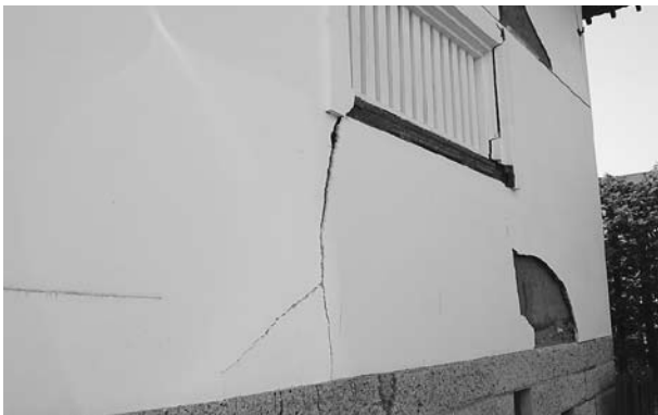
●釈迦堂の被災状況
