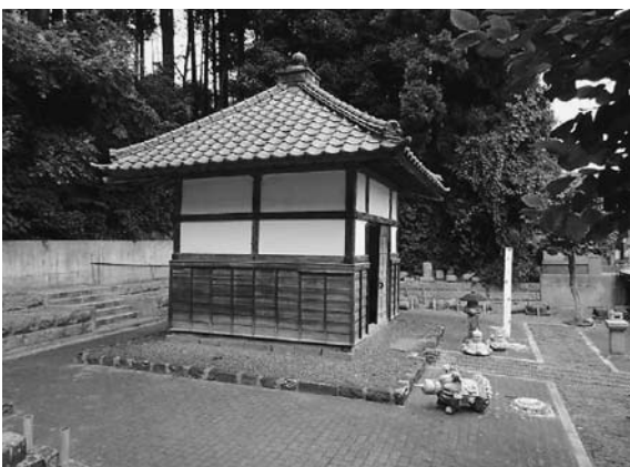
●建物全体がゆがんだ被災状況
