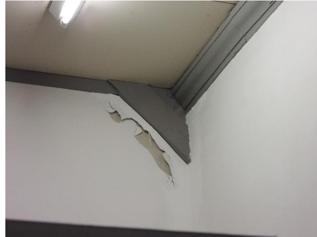
(市指定) 旧歩兵第四連隊兵舎 漆喰壁の剥落
