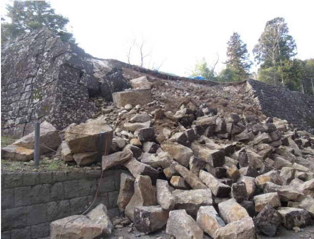
(国指定) 仙台城跡 本丸北西石垣の崩落
