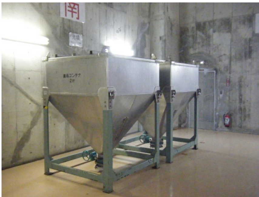
図2 高分子凝集剤コンテナ外観
