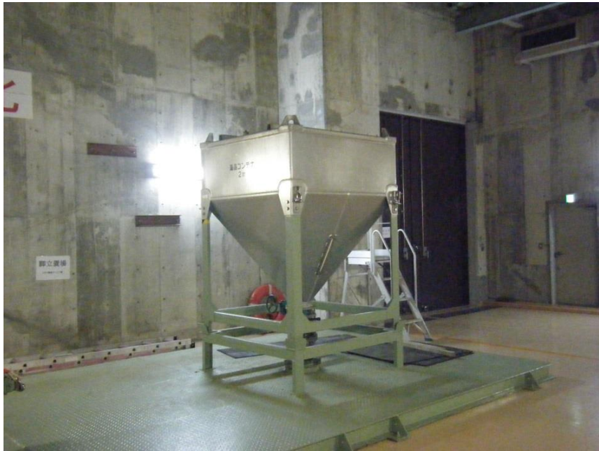
図1 高分子凝集剤コンテナ外観（設置状態）
