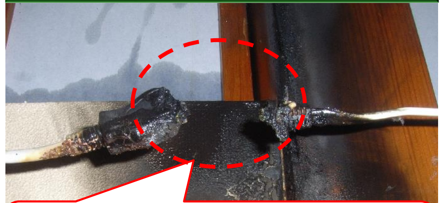
トラッキング現象により焼損したコンセント
