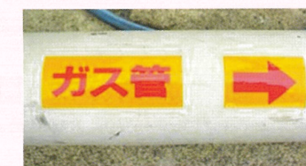
ガス管標示シール
