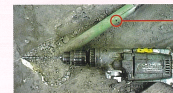
コンクリート内のガス管をドリルにより損傷した例
