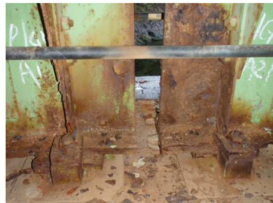
橋梁主桁の損傷状況
