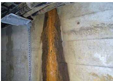
(目地の開き・漏水)
