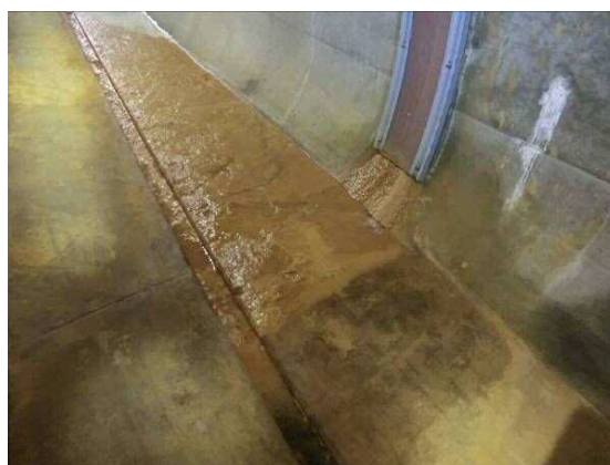
(土砂混じりの漏水の発生)
