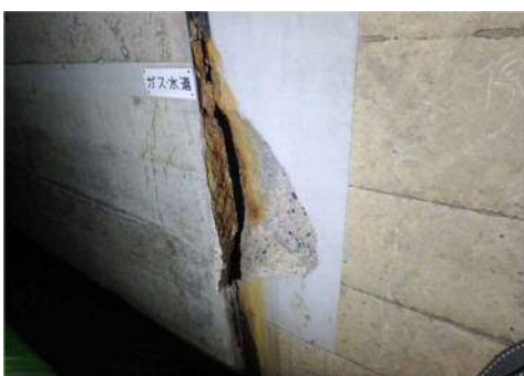
(コンクリートの剥落)
