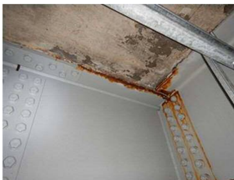
主桁の腐食【健全度：Ⅱ】
