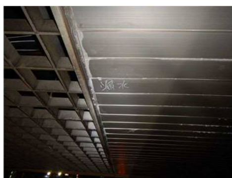
化粧パネルの漏水・滞水【健全度：Ⅱ】
