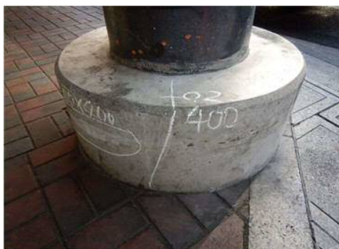
根巻コンクリートのひびわれ【健全度：Ⅱ】
