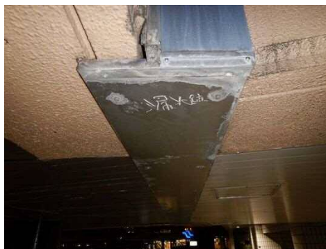
伸縮装置の漏水・滞水【健全度：Ⅱ】
