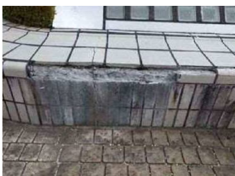
タイルの欠損【健全度：Ⅱ】
