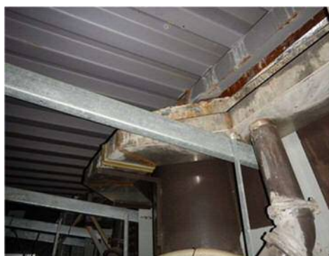
床版の腐食【健全度：Ⅱ】
