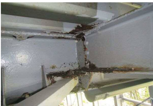
腐食【健全度：Ⅱ】
