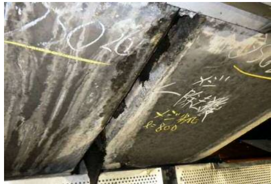
目地材の劣化【健全度：Ⅱ】
