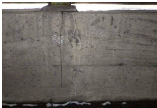
ひび割れ【健全度：Ⅱ】
