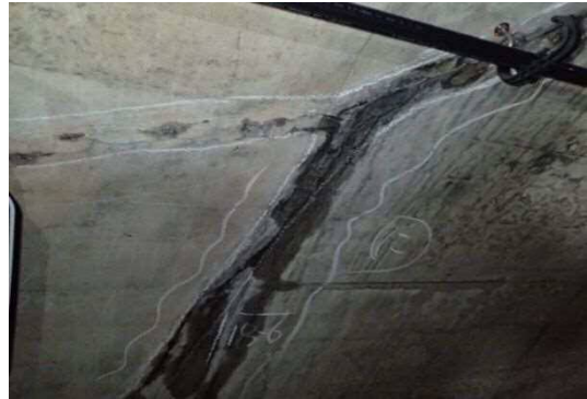
漏水【健全度：Ⅱ】
