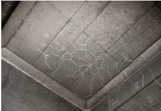
ひび割れ【健全度：Ⅱ】
