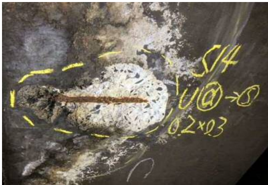
鉄筋露出【健全度：Ⅱ】
