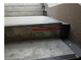
階段部のひび割れ
