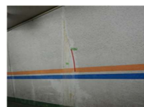
側壁のひび割れ・遊離石灰
