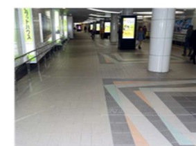
タイルのひび割れ
