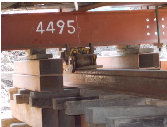
(連動ローラー設置状況)
