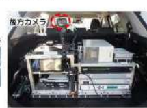
衛星通信装置
