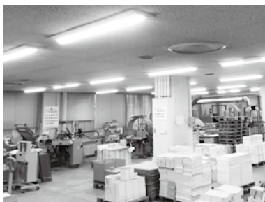
LED照明設備▶
