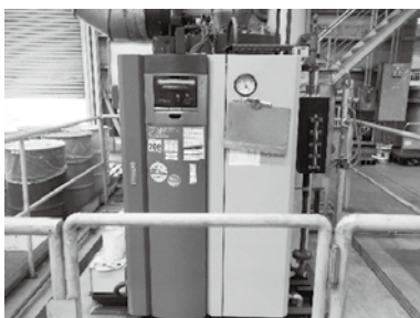
蒸気ボイラー▶
