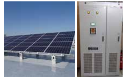
▲指定避難所の太陽光発電パネルとリチウムイオン蓄電池
