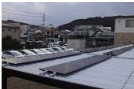
▲太陽光発電設備
