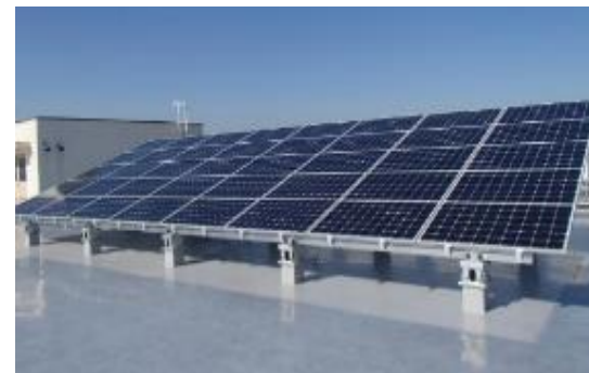
▲防災対応型太陽光発電システム
