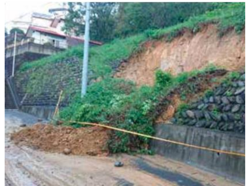
市内で発生した土砂災害（がけ崩れ） （令和元年東日本台風）
