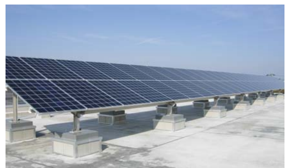
市役所の率先行動 公共施設等への太陽光発電システムの設置（仙台市立旭丘小学校）
