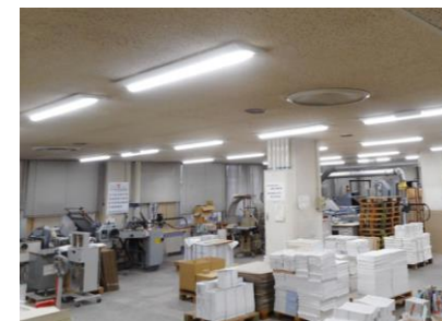
▲LED照明設備
