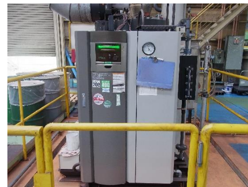
▲蒸気ボイラー
