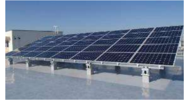
▲ 防災対応型太陽光発電システム
