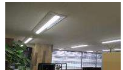
▲省エネ設備 (LED照明)
