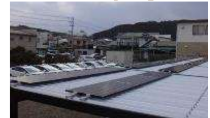
▲太陽光発電設備
