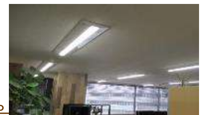
▲省エネ設備 (LED照明)
