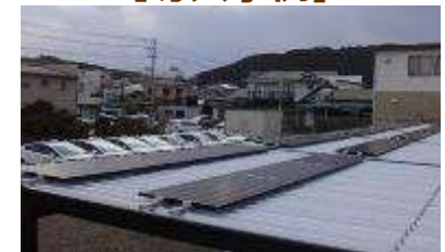
▲太陽光発電設備
