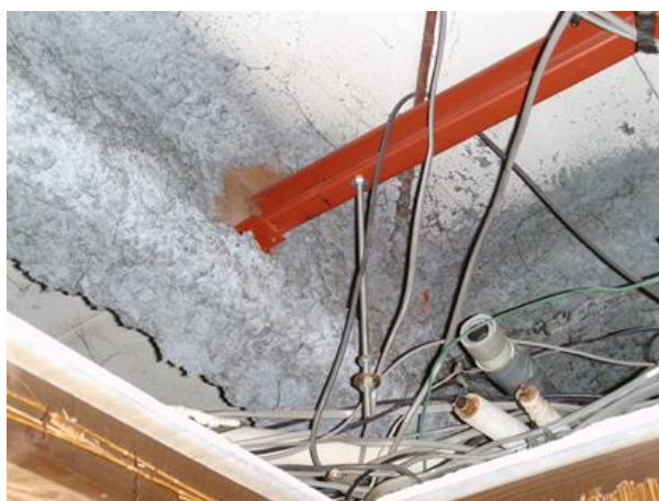
写真 8-1-12 損壊家屋建材中のアスベスト
