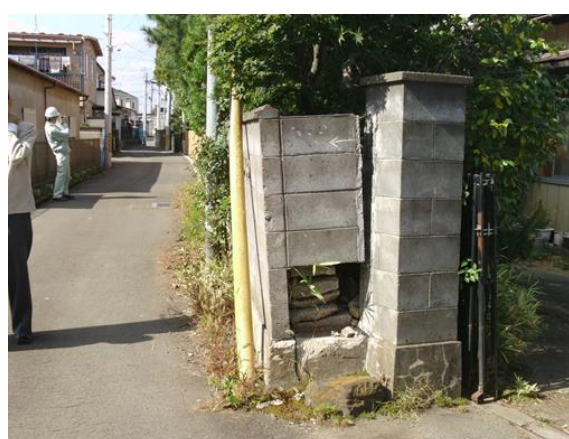
写真 8-2-2 損壊したブロック塀の状況
