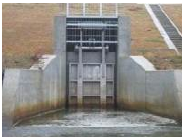
写真 1 フラップゲートの例
