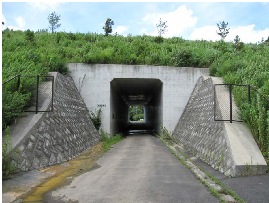
図 2.5-2 ボックスカルバートの例 (首都圏中央連絡自動車道[千葉県] 平成 22 年撮影)
