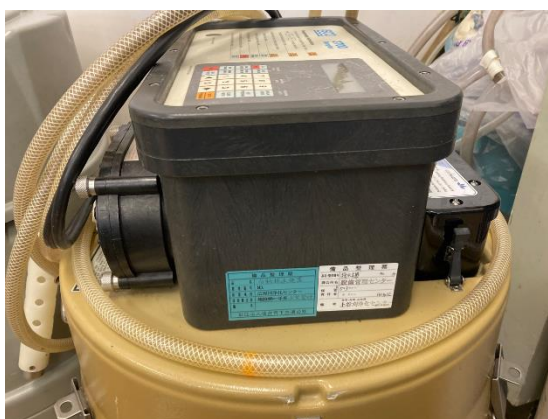
(図表 39 上谷刈浄化センターの備品の管理状況)
