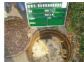
油が固まってふさがったマンホール
