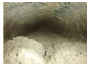
中で油が固まった下水道管
