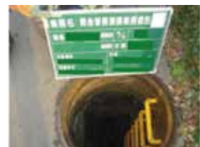
きれいなマンホール
