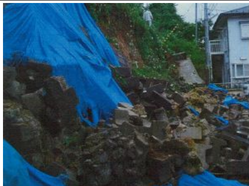
宮城野区東仙台：人家裏の法面崩壊
