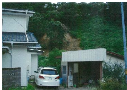
太白区三神峯：人家裏の斜面崩壊
