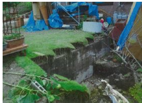
宮城野区岩切入山：法面崩壊による人家被害
