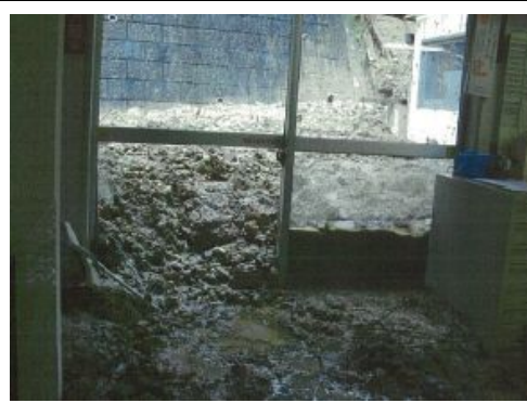
宮城野区岩切入山：斜面崩壊土砂の企業事務所への流入
