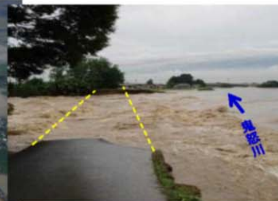
被災状況(拡大写真)
