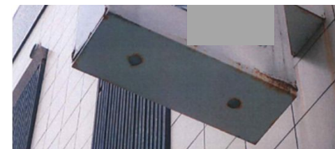
底板が腐食の可能性
