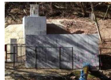
朴沢小水力発電所
