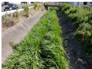
水路土砂堆積状況
