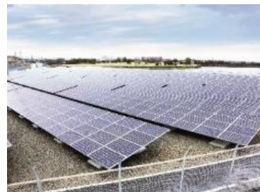
大沼太陽光発電所
