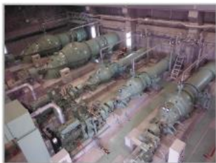
排水機場ポンプ
