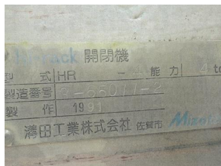
排水機場 河川ゲート開閉器名盤 (1991年製造)
