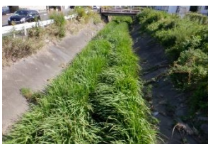
水路土砂堆積状況
