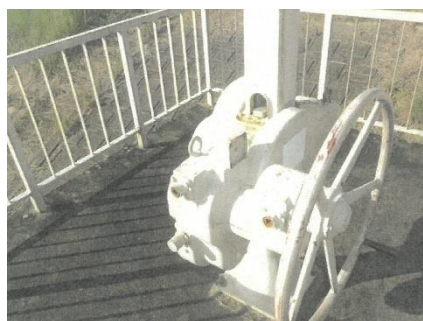
排水機場 河川ゲート
