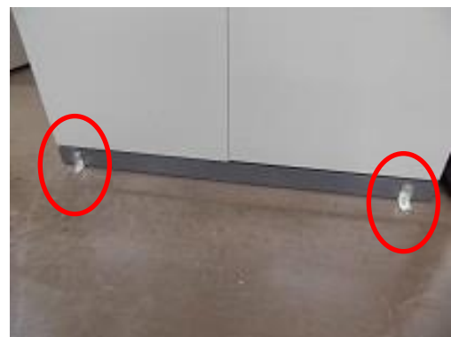
▲ 書棚の転倒防止対策の例
