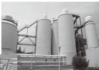
地震で4基が倒壊した工場内のタンク。現在は復旧しています
