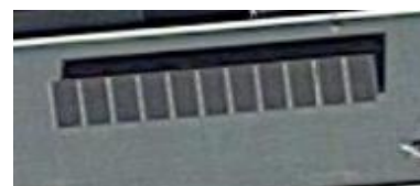
本校屋上の太陽光パネル
