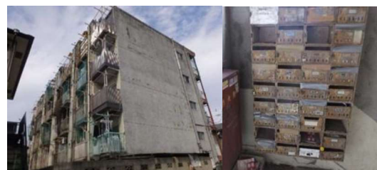
建物の傷みが著しく外壁の剥落、鉄骨の露出などが見られる事例
