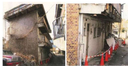
外壁、手すりが崩落した事例
