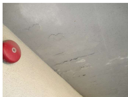
漏水による膨れ？
