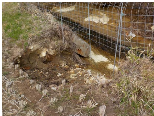
修繕前（畦畔の崩落）
