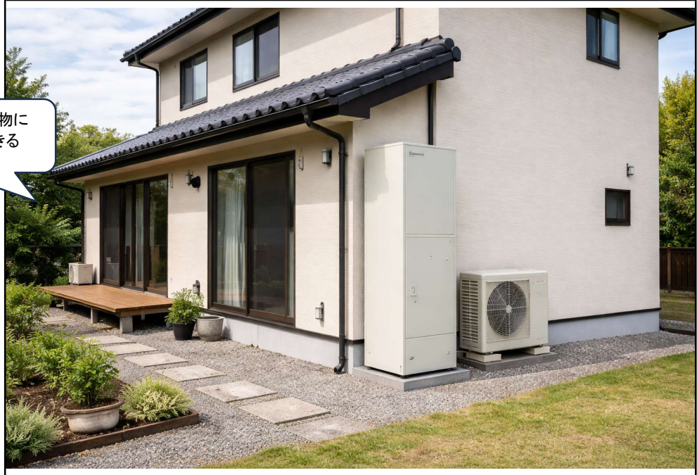
【工事後】 ②設備設置後の全体写真
