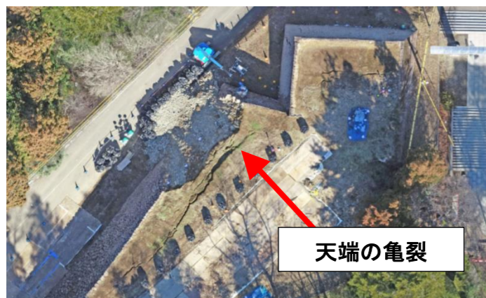
【写真1】石垣天端の亀裂
