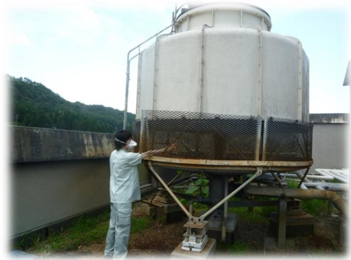
円筒型冷却塔
