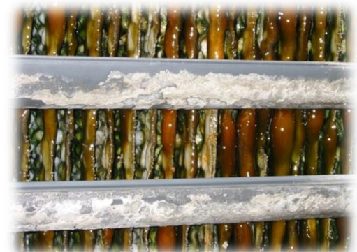
スケールがたまった冷却塔
