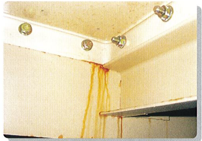
受水槽締結部から錆流出
