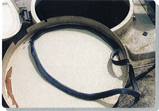
マンホール蓋パッキンの破損
