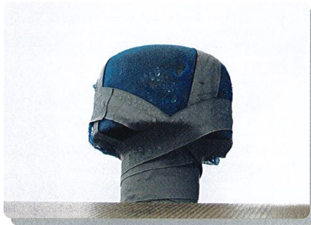
通気管防虫網の破損
