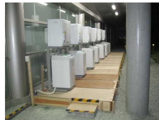
新たに設置された洗濯機と乾燥機 (2011.4.13宮城野体育館)
