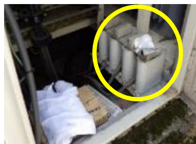
キュービクル内に残置された廃コンデンサー
