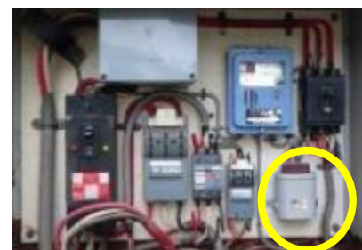
低圧分電盤内の低圧コンデンサー
