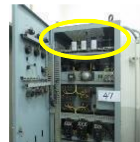
可変周波数電源装置の低圧コンデンサー
