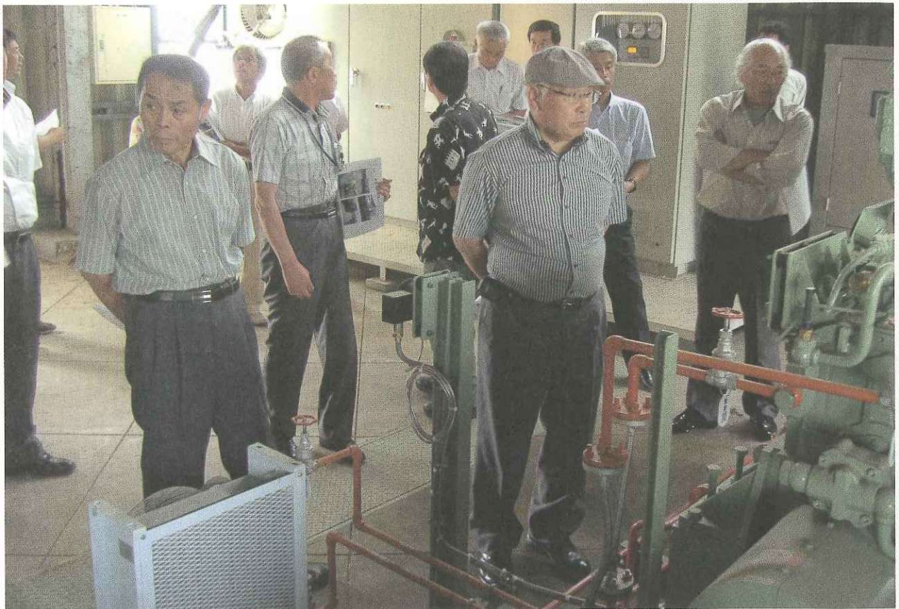
仮復旧した大堀排水機場（若林区）を視察する委員
