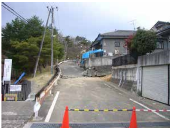
写真 折立五丁目地区（復旧前）
