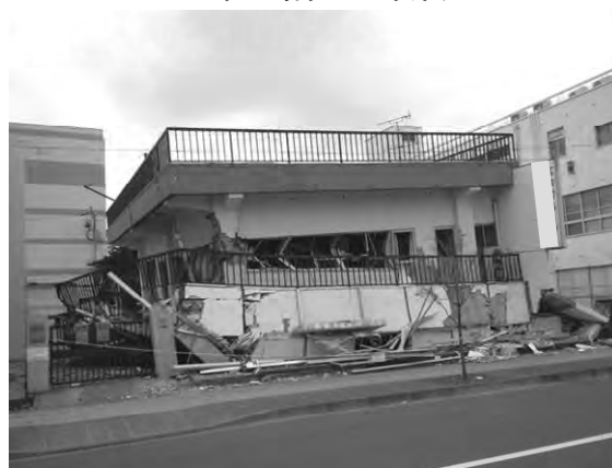
写真 建物被害例：若林区卸町（RC 2 階建て 1969 年・昭和 44 年築）
