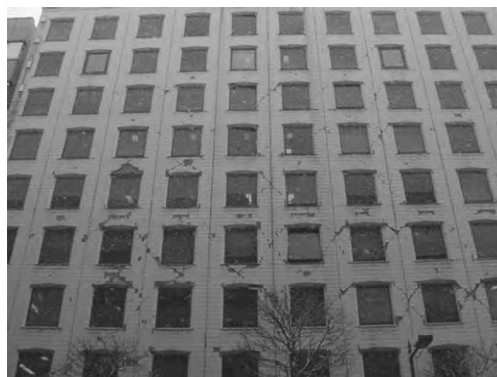
写真 非耐力壁におけるせん断破壊：青葉区一 番町（SRC 造地上 10 階地下 1 階 1972 年・ 昭和 47 年築）
