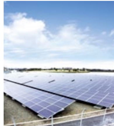
大沼太陽光発電所が稼働。売電収入は東部地域の農業用排水機場の維持管理費にあてる(3月)
