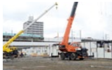
10月、プレハブ仮設住宅の解体・撤去を開始(あすと長町仮設住宅)
