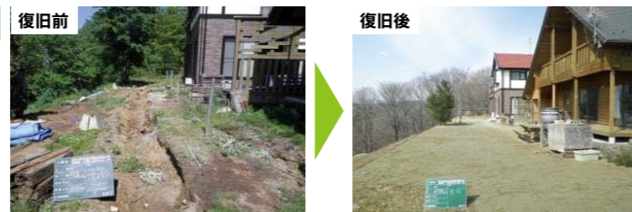
内陸丘陵部の宅地被害と復旧状況(青葉区高野原一丁目)
