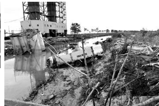
高砂南部排水機場 (宮城野区蒲生)
